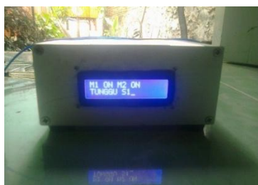
Gambar 7. Indikator Pompa Air 1 Dan Pompa Air 2 ON
